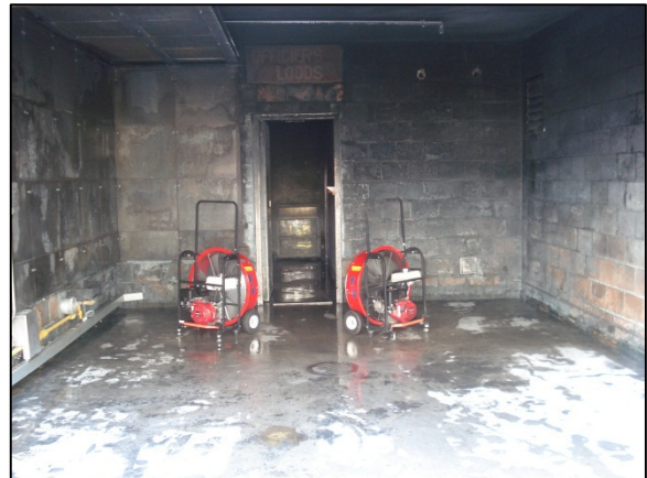
Figuur 10 Opstelling van ventilatoren in V in een lokaal waar de zijmuren te dicht staan en er niet voldoende lucht kan worden aangezogen door de ventilatoren (Foto: Karel Lambert)
